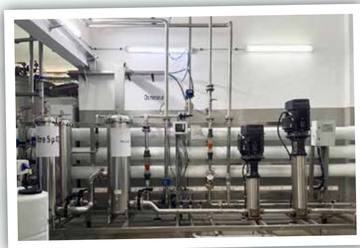
Unité d'osmose inverse pour la réutilisation des eaux traitées en nettoyage de surfaces à STBG Megrine
